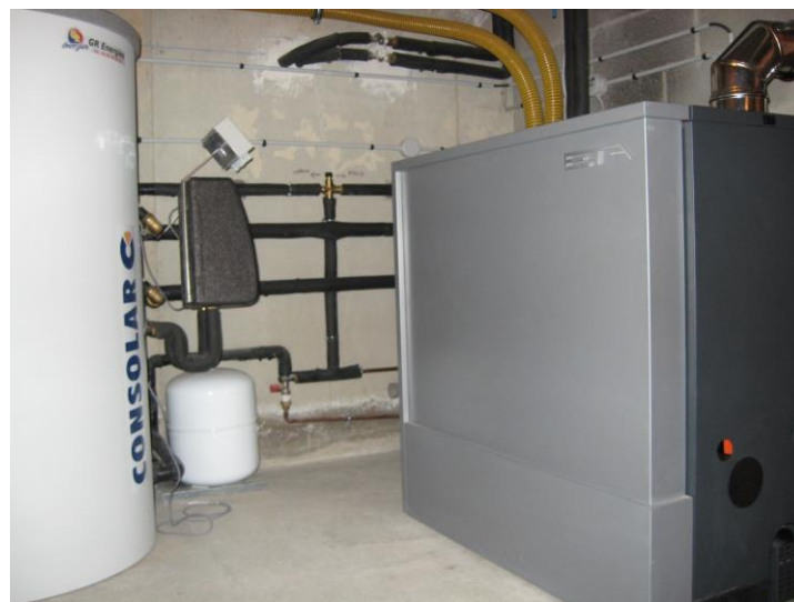
Chaudière à granulés de bois ETA pour le chauffage de la maison et l'appoint d'eau chaude sanitaire
