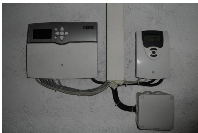
Régulation solaire et centrale de mesure permettant de compter l'énergie produite par le solaire et par l'appoint, ceci permet de vérifier l'efficacité de l'installation
