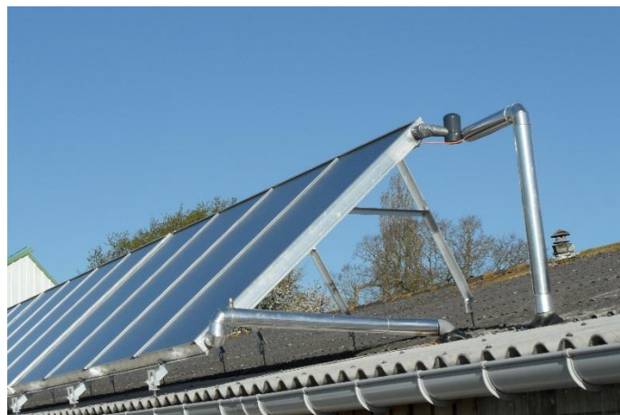
Tuyauterie acier avec isolation laine de roche et revêtement aluminium
