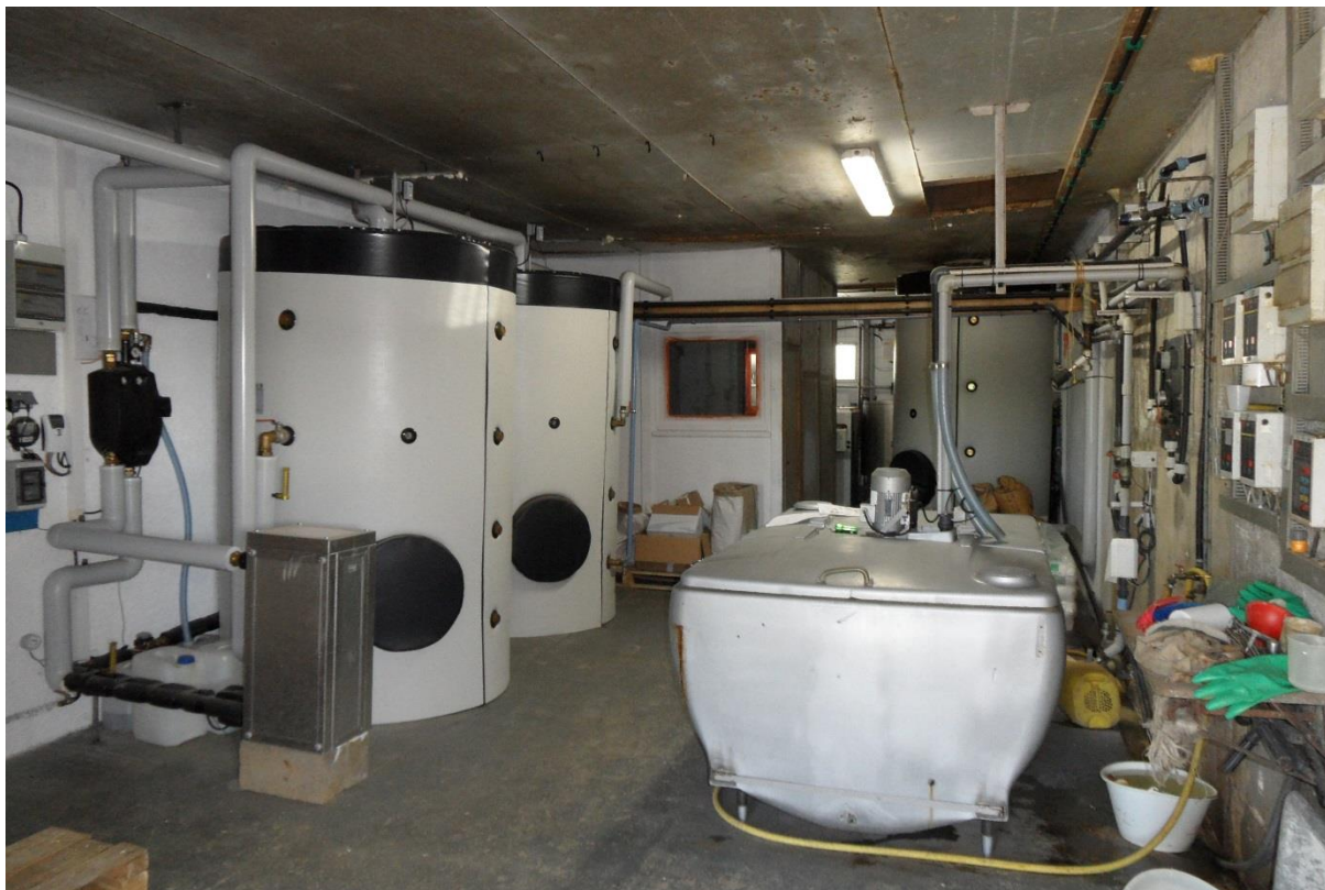
Vue d'ensemble de l'installation intérieure, comprenant l'échangeur à plaque et la station solaire, 2 ballons de stockage d'eau chaude sanitaire de 2500 litres et un ballon d'appoint de 3000 litres
