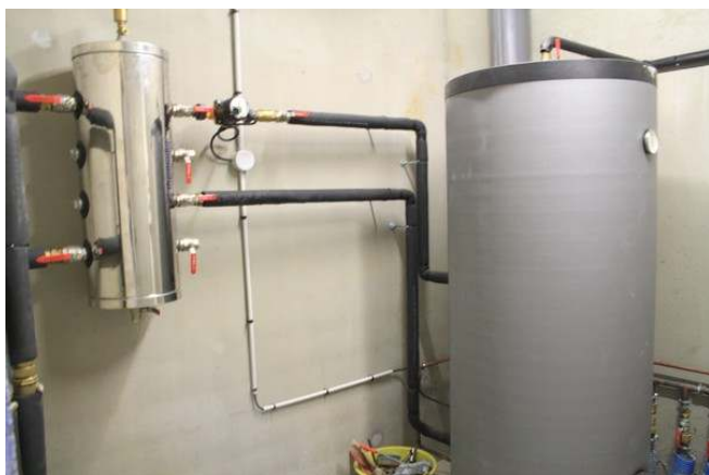
Sous-station et ballon d'eau chaude sanitaire de 200 litres
